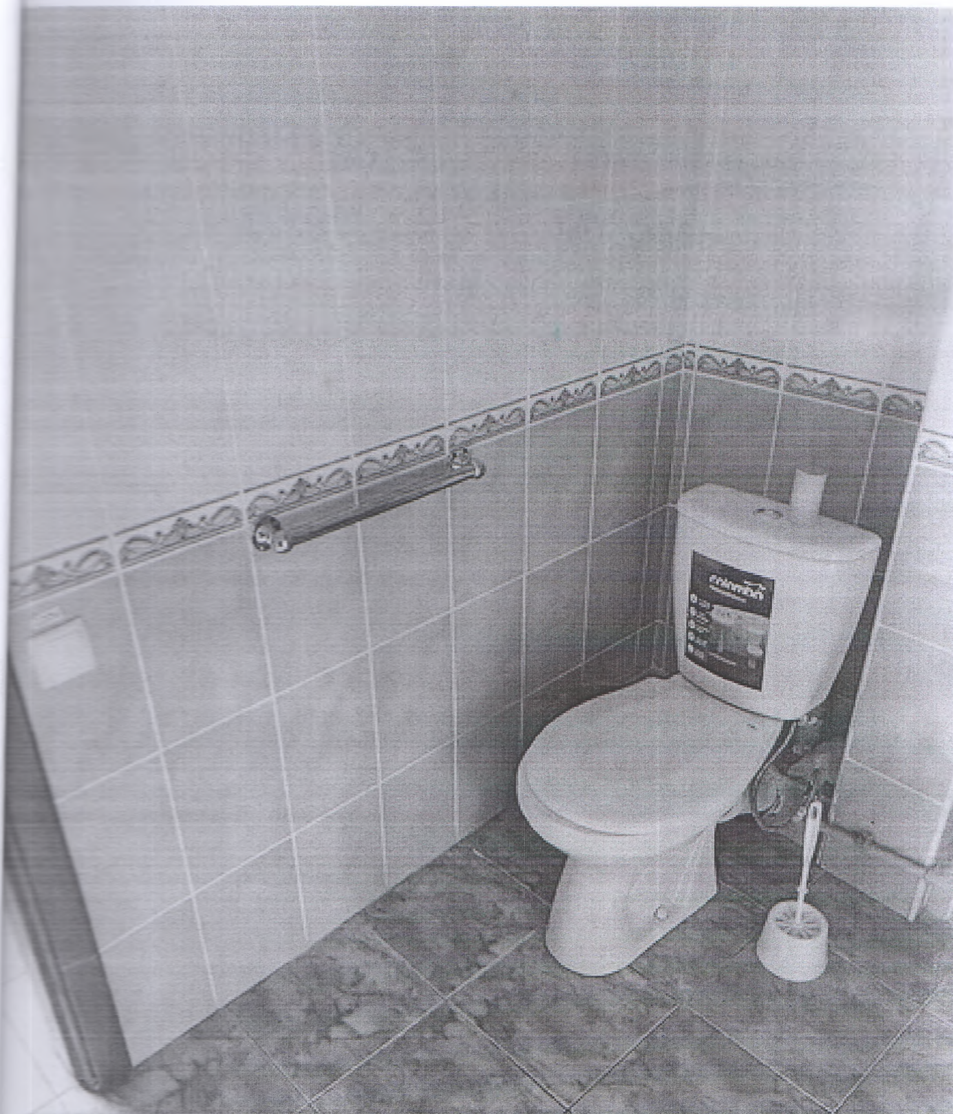
Обладнання санвузла на 2-му поверсі гуртожитку
