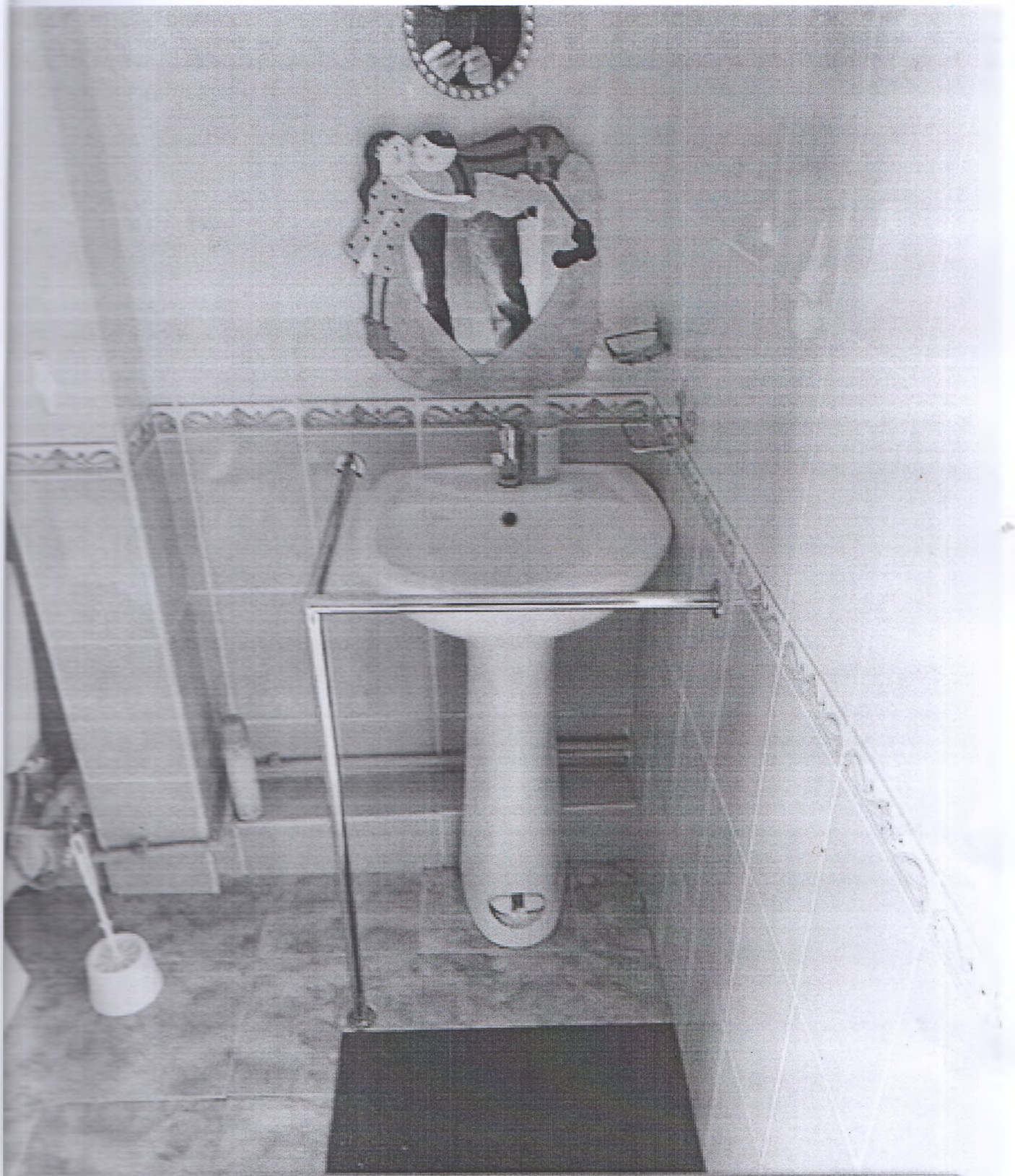
Обладнання санвузла на 2-му поверсі гуртожитку
